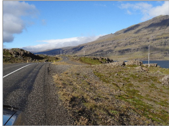
Mynd 12.2.13. Útflattar vegaxlir og brotnir vegkantar er algeng sjón á þessum kafla.
