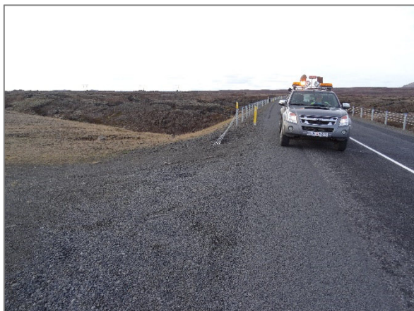
Mynd 9.2.32. Mikið stoppað við vegriðsenda beggja jarðfallsins við Austari Brekku
