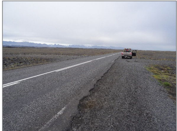
Mynd 2.2.2. Austan brúar yfir Núpsvötn. Vegkantur er víða illa farinn.
