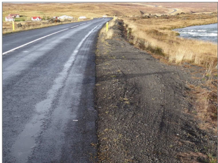
Mynd 9.2.9. Vegurinn austan Helluvaðs. Víða má sjá útflatta vegkanta.
