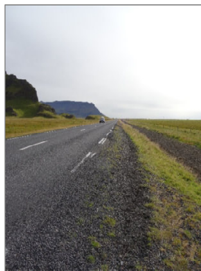
Mynd 2.2.40. Vegkantar við Hvamm eru mjög illa farnir.
